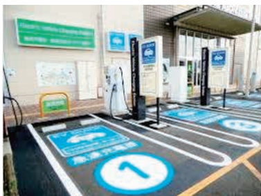
EV充電ステーション
