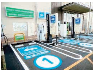
EV充電ステーション
